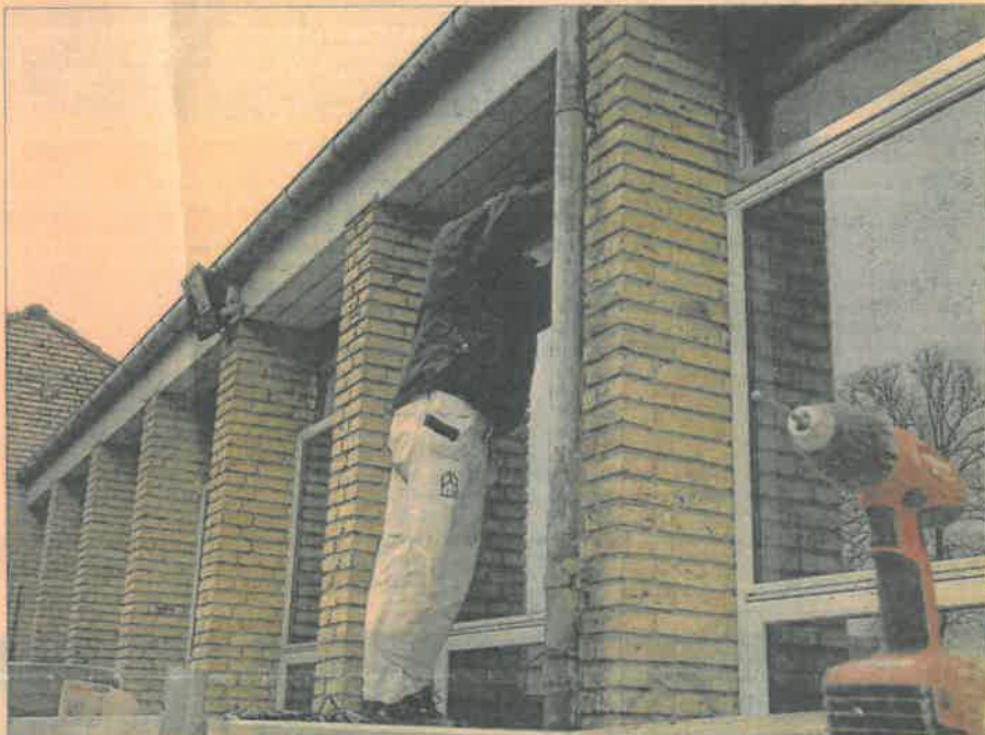
De 10 sjællandske malermestre mener, at de har en fælles forpligtelse til at bekæmpe PCB på skoler, offentlige og private institutioner samt private boliger. Her er udskiftes der vinduer på Borup skole på grund af PCB. Foto: Bjørn Armbjørn
